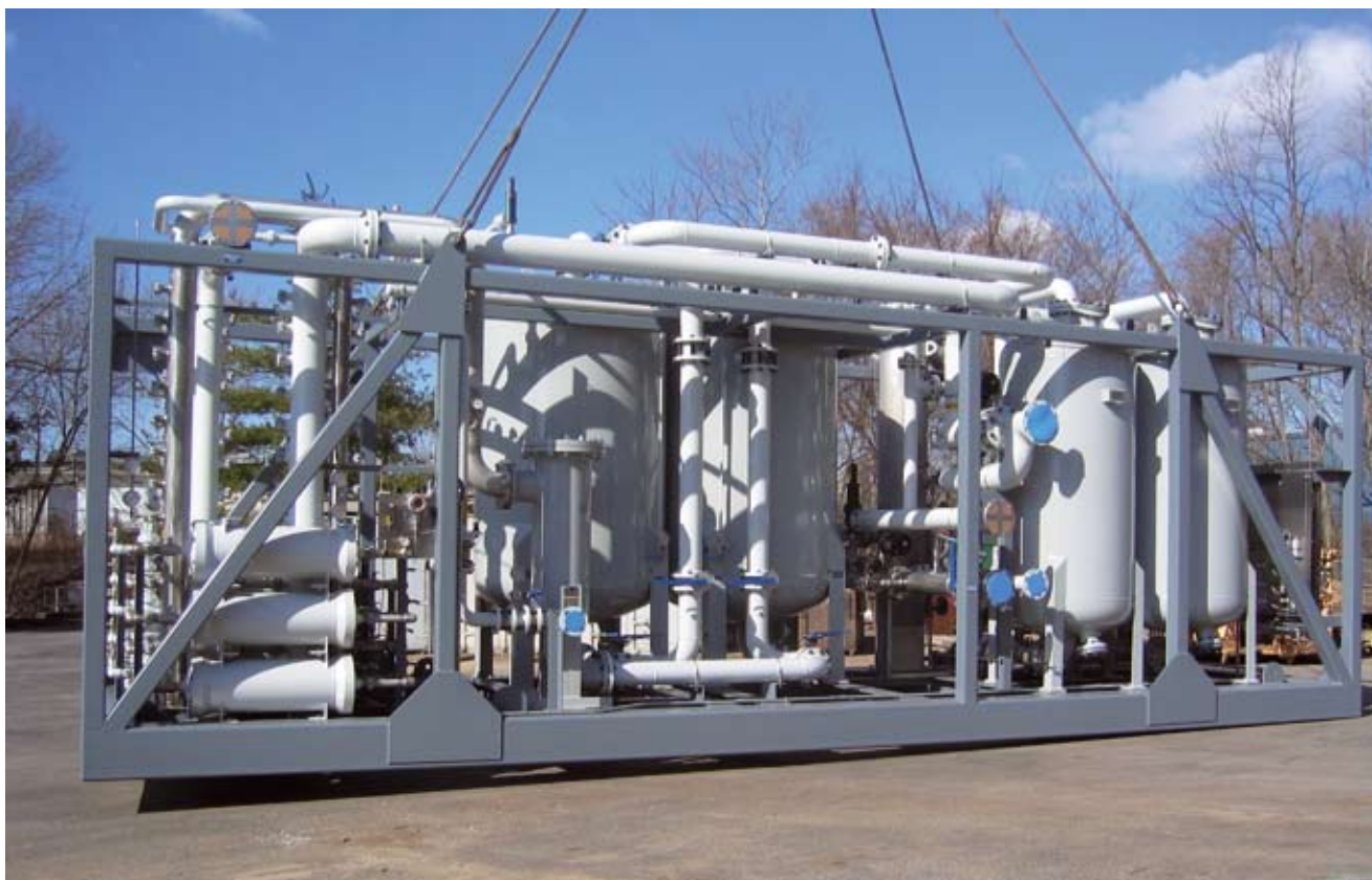
À gauche : le système de membranes bi-étagé permettant l'élimination du gaz carbonique. Au centre : le module PSA (Pressure Swing Adsorption). À droite, les deux colonnes de charbon actif permettant l'élimination des COV, des siloxanes et des hydrocarbures.
